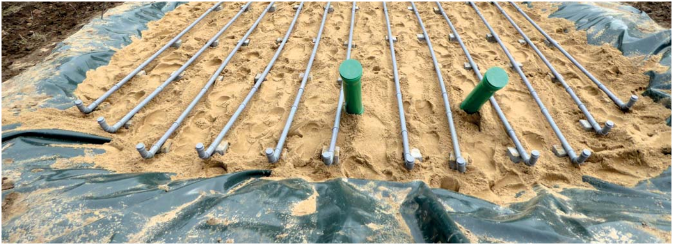
Beschickungsrohre und Revisionsöffnungen der Dränung
